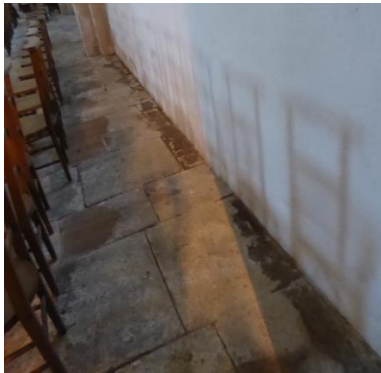
Mur Nord, zones humides sur le sol, mais le mur reste sec (cimenté ?)
