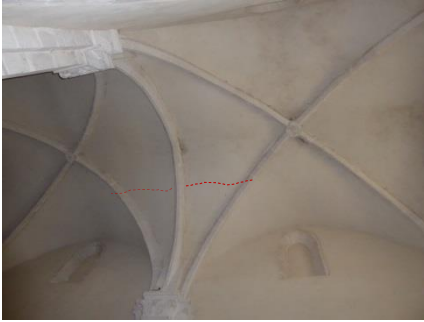
Bon état général des croisées d'ogives- légère fissure autour du doubleau entre 1ere et 2e travée
