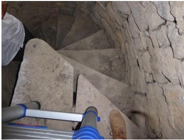
Escalier tourelle- Marches disjointes-
