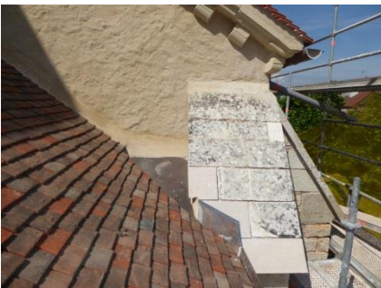
Type de besace de report d'eau en cuivre à prévoir derrière la tourelle d'escalier.
