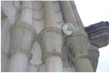
Recherches de badigeon redonnant une unité au portail, sur la base d'une compatibilité avec les teintes de base du mortier.
