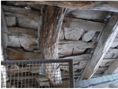
Les lattes d'origine sont souvent insuffisantes à retenir le glissement possible des pierres de doli et des chevrons sont mouillés.- Transept Nord.
