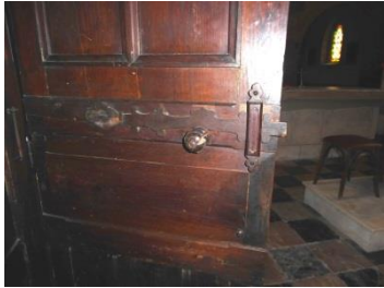
Porte sacristie -La poignée en bois est fendue
