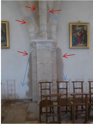
Entre 1 ère et 2 e travée Nord- Fuite apparaissant sur les piles et sur le doubleau
