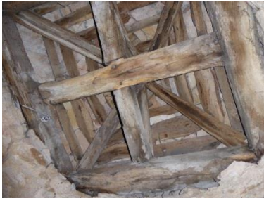
Sous-face de la couverture tourelle à maintenir en sous-œuvre.
