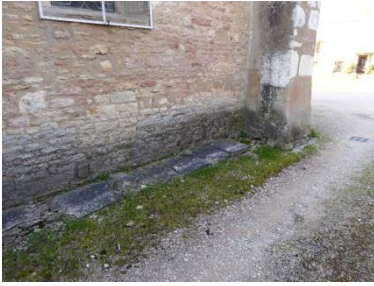
Effet des dalles de pierre posées à plat sur les soubassements tachés par rejaillement, au - dessous, on trouve un cailloutis sur sable
