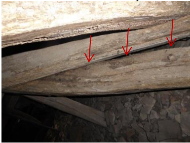
Trous de chevilles du dessus des chevrons visibles dans la pénétration de l'escalier d'accès- pas de renfort du doli dans les noues courbes.
