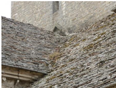
Noue ronde de pénétration peu négociée- fort emmoussement et casses
