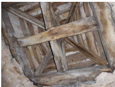
Sous-face de la couverture tourelle à maintenir en sous-œuvre.
