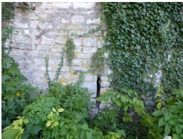
Chantepleures des murs périphériques du site ; l'imperméabilisation des sols, par compactage ayant réduits leur rôle d'arrosage filtré des jardins remplaçant les fossés
