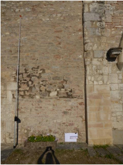
Façade Ouest- haut contrefort Nord à pierres arrondies- moellons éclatés par un incendie faisant éclater l'enduit après les remontées capillaires causées par l'enduit ciment aujourd'hui supprimé
