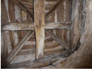
Glissement de la couverture en laves
