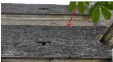
Egoût Sud, comparée à la photo de l'Inventaire, l'affaissement de la rive adossée semble fortement atténué, mais subsiste.
