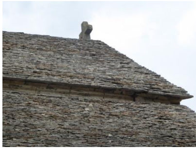
Bas-côté Nord, léger affaissement, mousses et casses visibles- la nef en état correct, le haut des bas-côtés en état moyen est à réviser, le solin est fissuré et les laves supérieures en état de glisse
