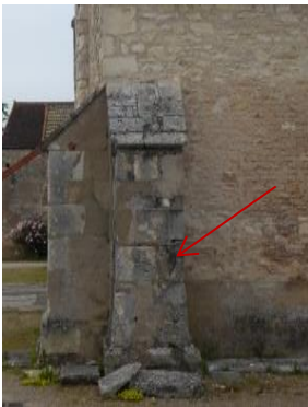
Contrefort avec pierres d'angle en délit gélives, écornures et reprises en ciment
