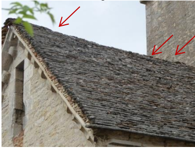
Transept Nord : des manques ou perturbations visibles sur la ligne de faîte.
