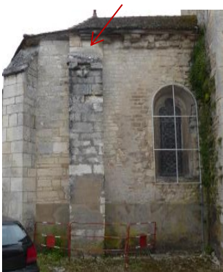
Façade Nord du chœur- tête du contrefort éclatée au gel et perte de matière. plinthe ciment conservée
