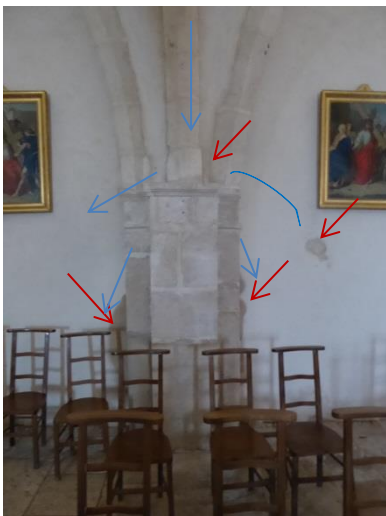
Fuite apparaissant sur les piles et capillarité isolée, en correspondance extérieur avec des cavités, trous de scellement.
