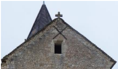
Façade principale, amollissement des rives comparée au transept Sud où les reliefs sont marqués :
